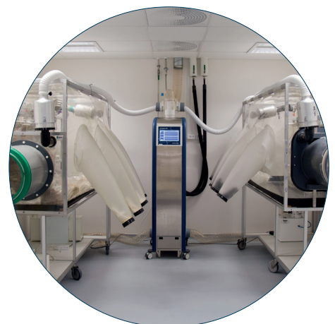
ScanClima liefert befeuchtete/entfeuchtete Luft an Isolatoren
